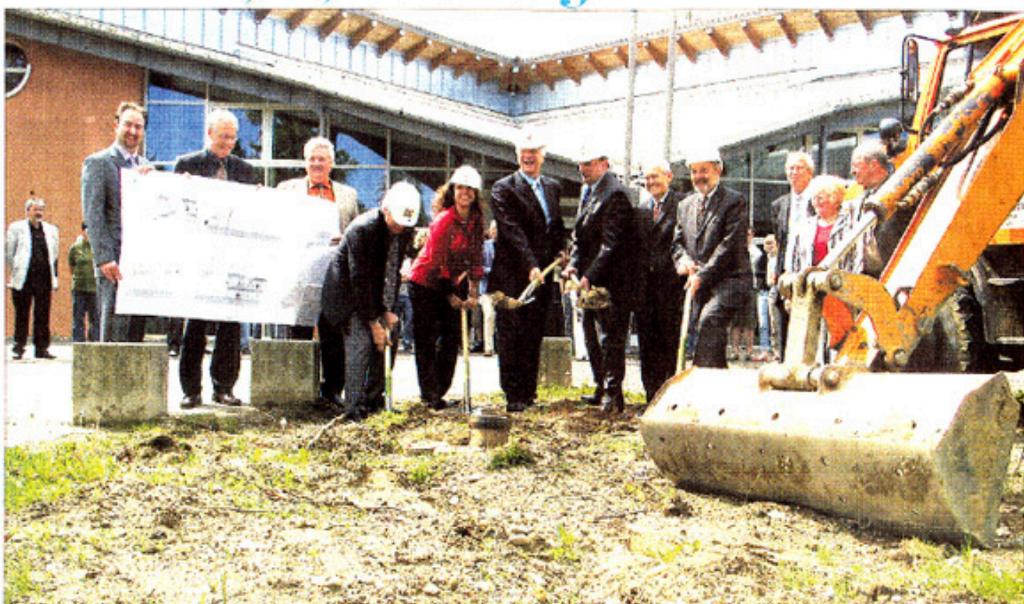
Schaffe, schaffe, Schule baue: Nach dem Festakt ging es zum offiziellen Spatenstich, bei dem Landrat Christian Knauer (Mitte), Rektor Gerhard Haunschild (rechts daneben) sowie Vertreter des Kreistags, der Baubehörde und des Architekturbüros zum Spaten griffen. Die Erweiterung schließt an die Glasfront der Aula (im Hintergrund) an. (Fotos: Lautenbacher)
